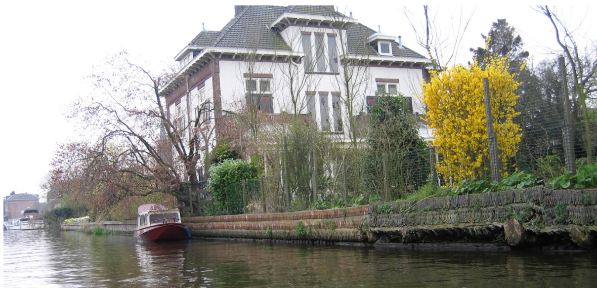
Door peilverlaging is de sloof boven water gekomen en ingerot, Straatweg 172, Breukelen (2004)
