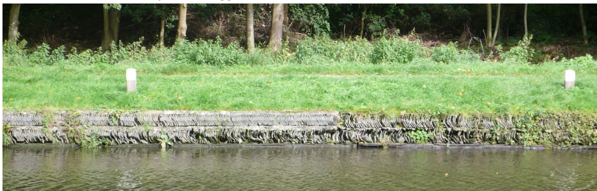
Deze foto laat goed zien hoe de sloof boven water is gekomen en verrot (2007)
